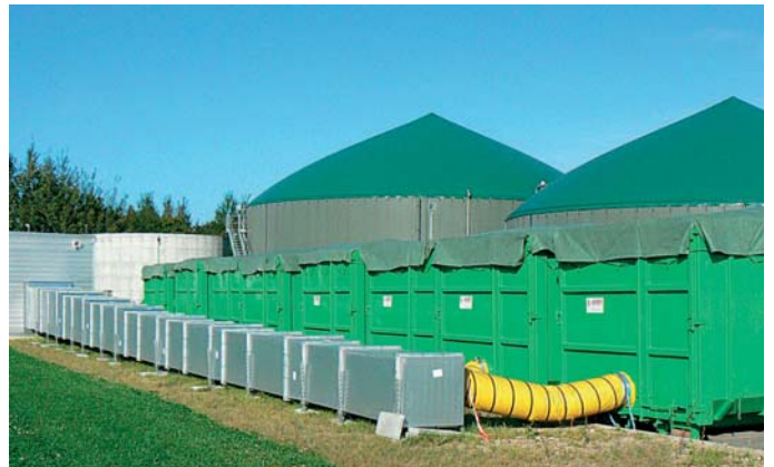
Séchage en conteneur mobile avec chaleur résiduelle d'une installation de biogaz. (Moser, 2015).
